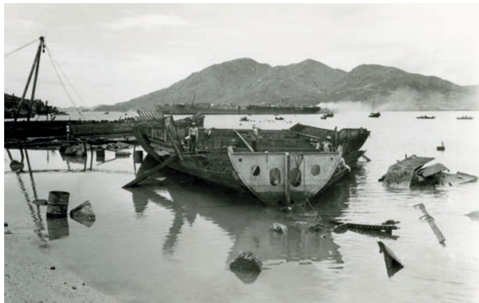
4.6 在醉酒灣進行的拆船作業，1960年。 Ship being dismantled at Gin Drinkers Bay in Kwai Chung, 1960.
